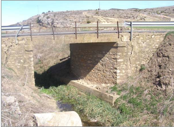
Agrietamientos en las aletas del puente de la carretera SO-V-6921 sobre el río Manzano.
