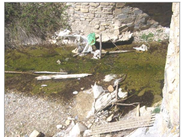
Descalce del puente de Cigudosa.
