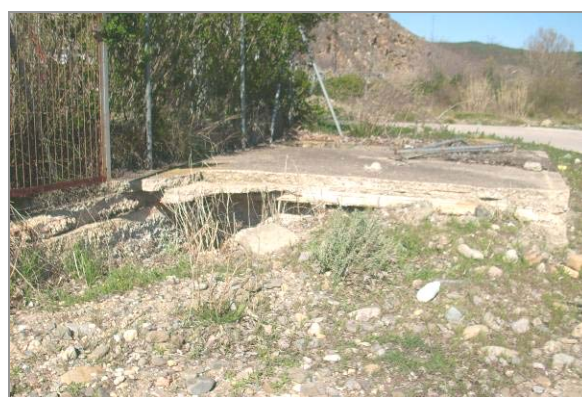
Restos de la EDAR de Venta de Baños arrastrada por la riada de 2002
