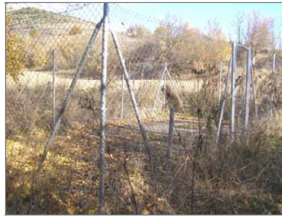
Tanque Imhoff para el tratamiento de las aguas residuales del municipio de Santa Cruz de Yanguas
