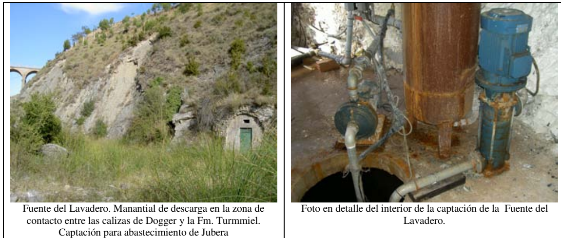
Figura 3.16: Fotos representativas de las características y problemas de la masa de agua subterránea de Fitero-Arnedillo (66).
