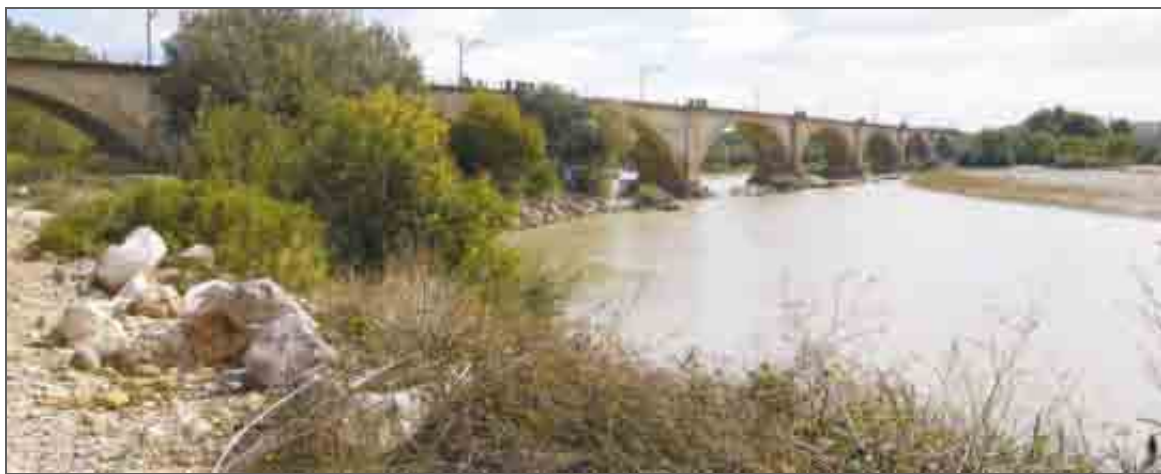
Mota del puente del ferrocarril. En las avenidas del 2003 y 2007 en este punto se salió el agua de la llanura de inundación, provocando la rotura de la mota.
