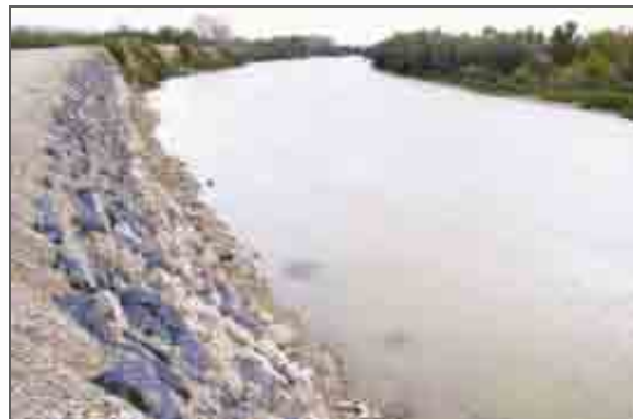
Escollera destruida en la avenida de 2003 en el termino de Arguedas, reconstruida por el gobierno de Navarra
