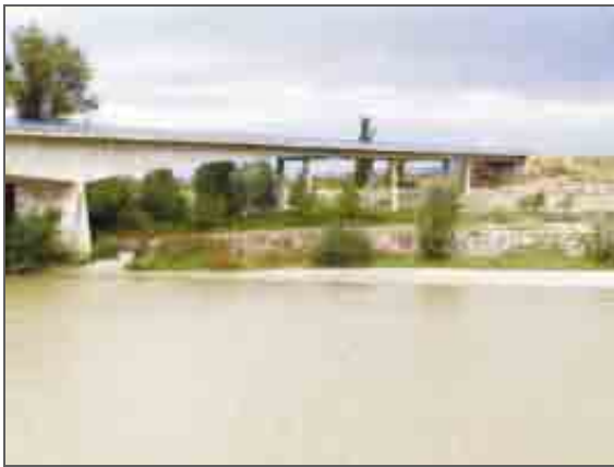
Después de la avenida de 2003 el puente de la N113 Pamplona - Madrid sobre el río Ebro presenta problemas de estabilidad, para lo que fue necesario colocar refuerzo con zapatas de goma.
