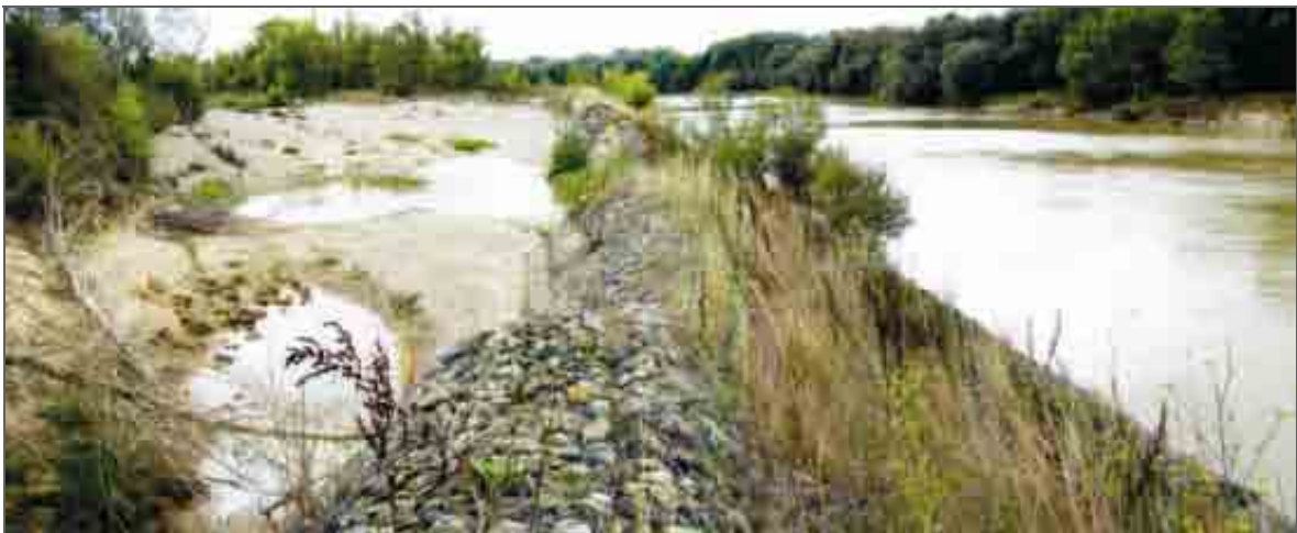
Gavión sobre la margen izquierda del río en el término de Valtierra, construido en 1997. Fue desmontado por la riada de 2003. Esta mota no se ha reparado porque no se ha terminado la concentración parcelaria.
