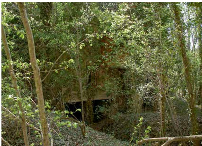
La vegetación ha invadido el molino de Agapito en Ventas Blancas, donde se aprecia el hueco del cárcavo.
