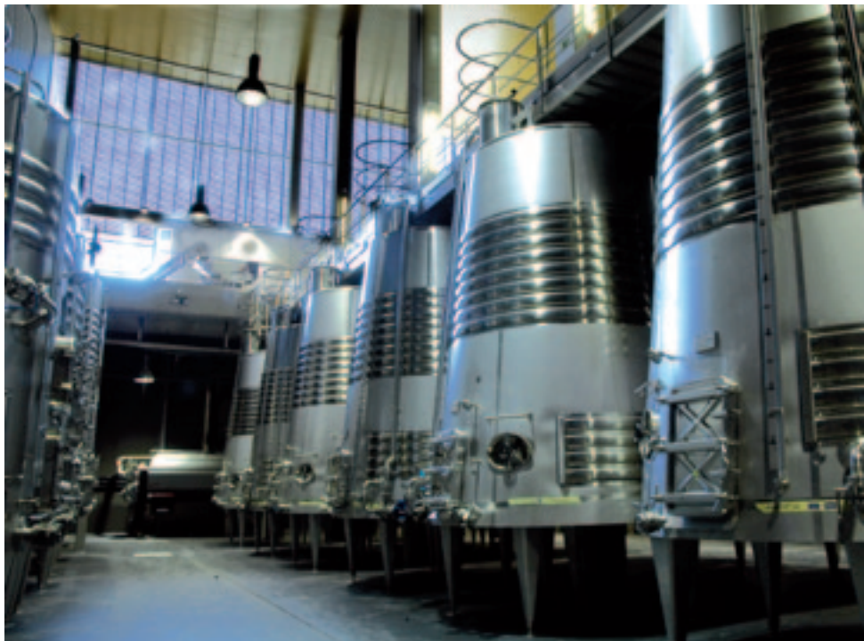
El control de fermentaciones se realiza con energía geotérmica, al igual que toda la climatización de los edificios.
