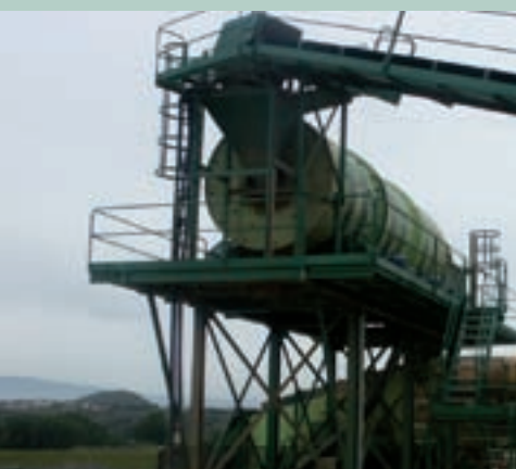
Equipos de la planta de tratamiento
