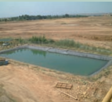
Balsa de recirculación de agua
