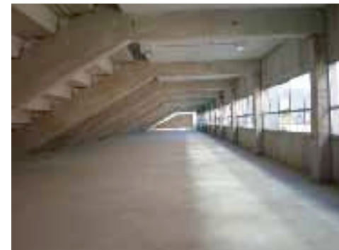
■ Espacio interior de las gradas donde se ubicarán las pistas cubiertas de atletismo
