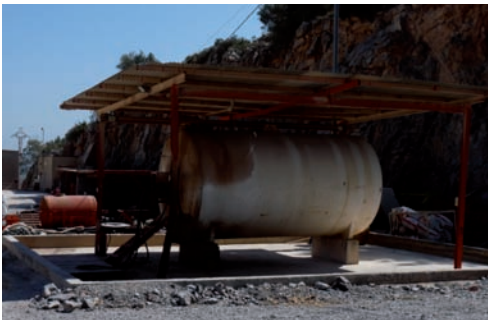
Depósito de gasóleo
