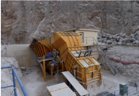
Inicio del circuito primario
