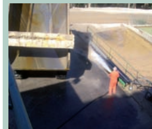
Recogida de las aguas de limpieza de los equipos móviles
