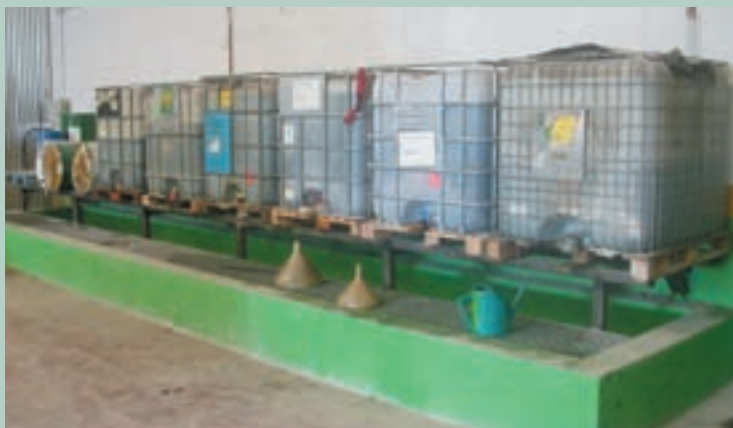
Cubeta de retención de líquidos en zonas donde puedan existir derrames de aceites y de combustibles
