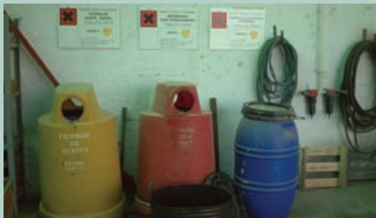
Depósitos para filtros de aceite y para trapos con hidrocarburos, señalizados
