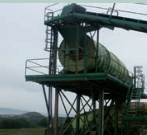
Equipos de la planta de tratamiento
