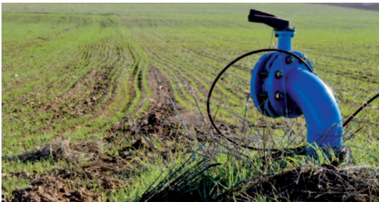
Desde los hidrantes el agua llega a la cada finca a través de las bocas de riego.
